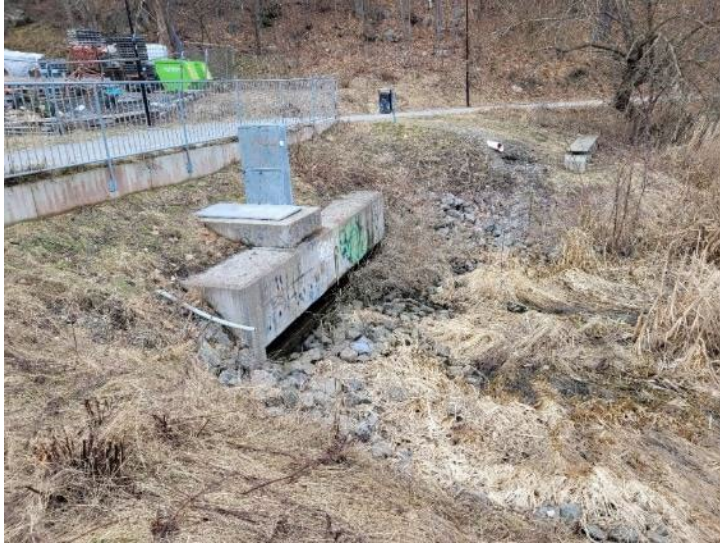
Figur 14. Utlopp från befintligt reningssystem för dagvatten innan utlopp till Svindersviken.
